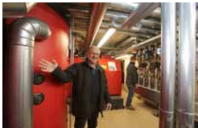
Hans Peter Giepen an der Pelletheizung der Kirchengemeinde Güchenbach © ekir.de/Thomas Seeber
