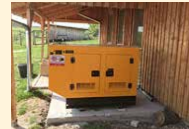
Ein neuer Generator hilft bei der Arbeit
